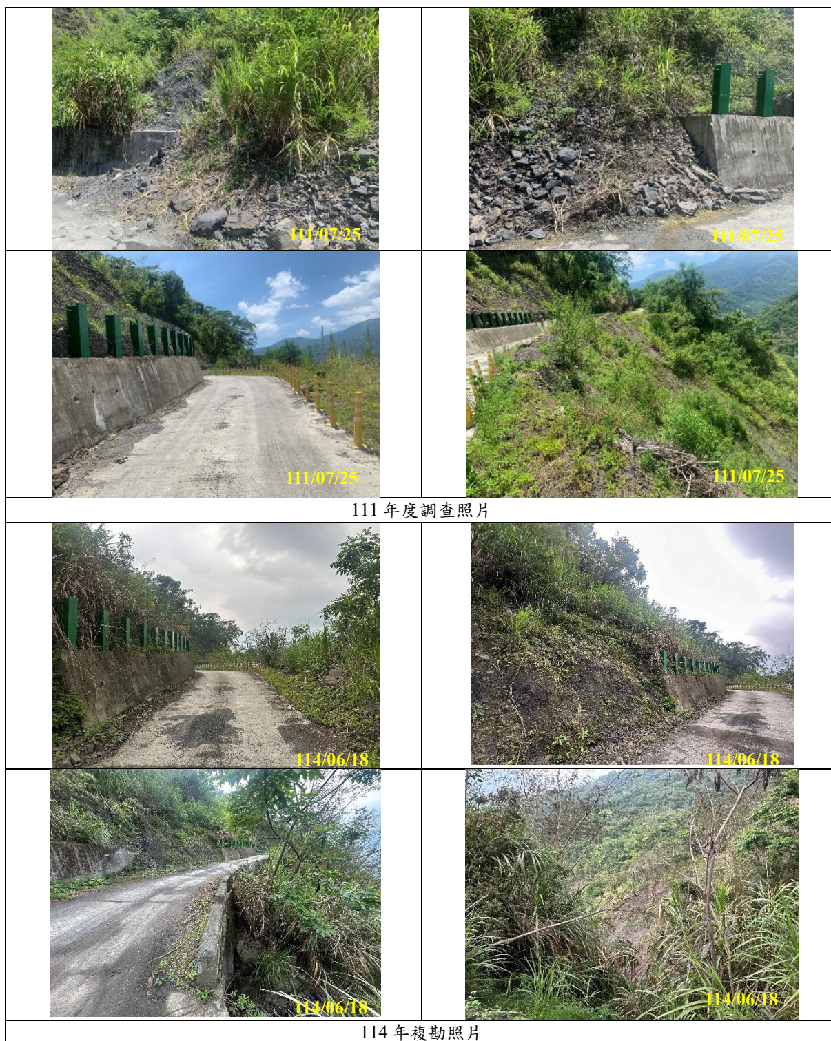
圖 3-6 EDP003 災害點位 2 複勘照片
