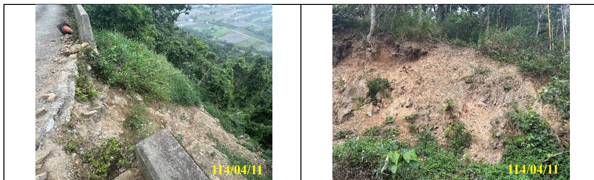
圖 3-12 農東延 211 1K+957 處災害照片
