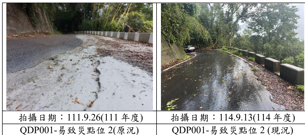
圖 3-5 QDP001-易致災點位 2 原況與現況
