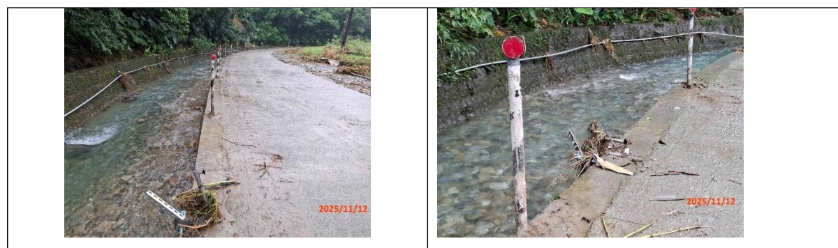
圖 3-11 鳳凰颱風外圍環流沖壞猴猴坑溪水水位計
