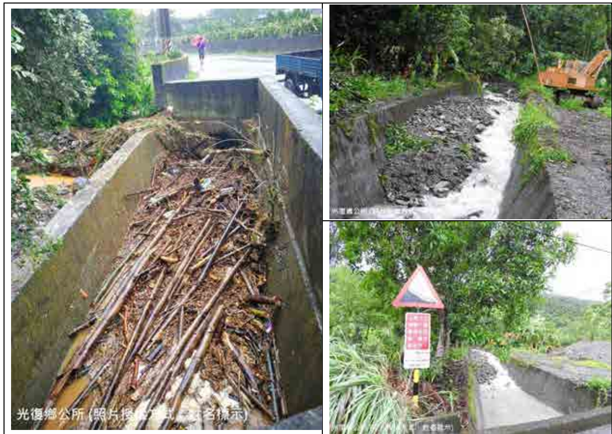
圖 4-12、白鹿颱風期間花蓮縣 DF-122 土石堆積於河道
