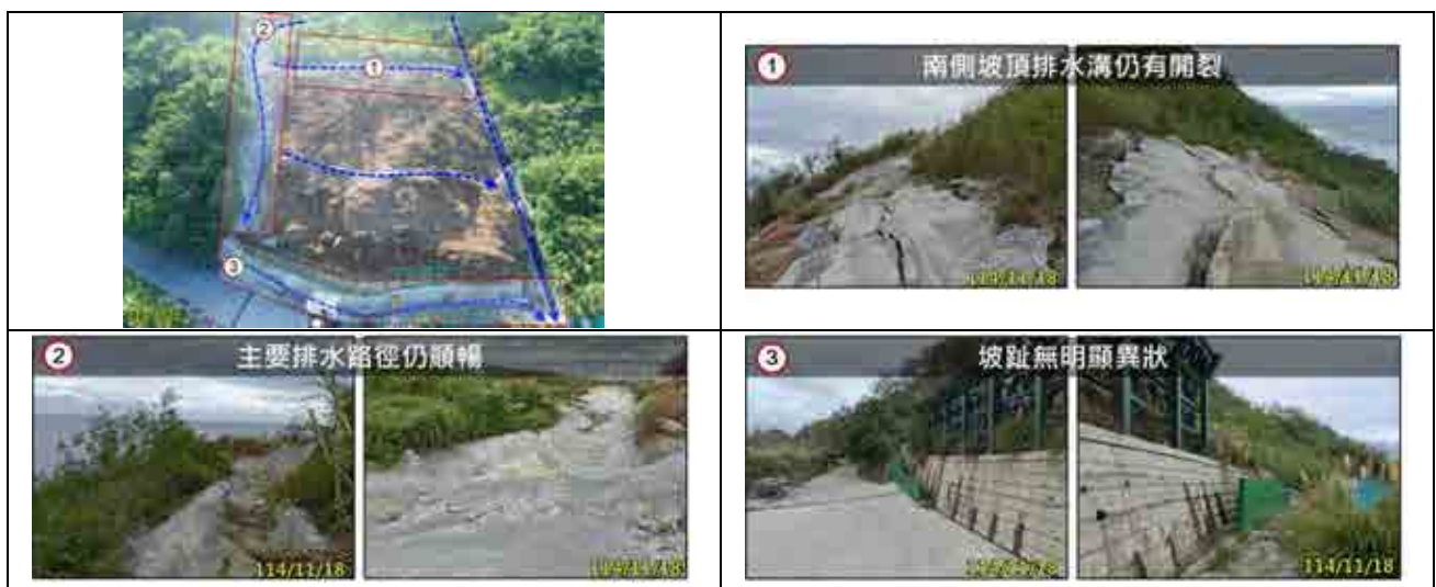
圖 3-106、第三期工程完成後局部區域建議改善缺失(南側頭部開裂)
