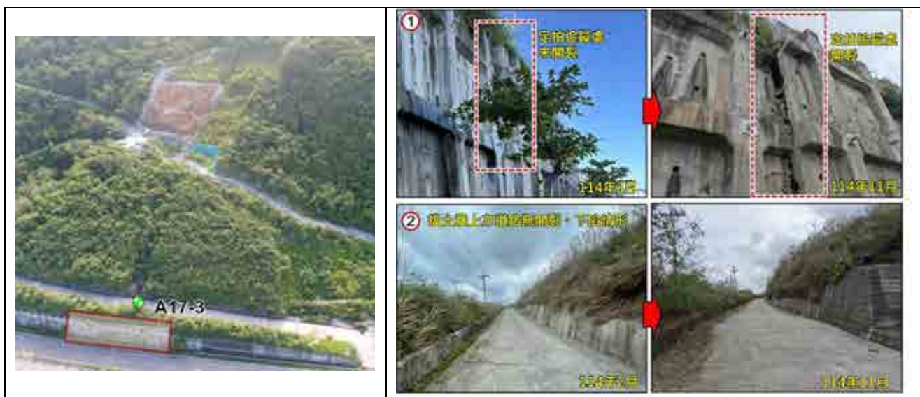
圖 3-108、第三期工程完成後局部區域建議改善缺失(坡趾地錨擋土牆定開裂)
