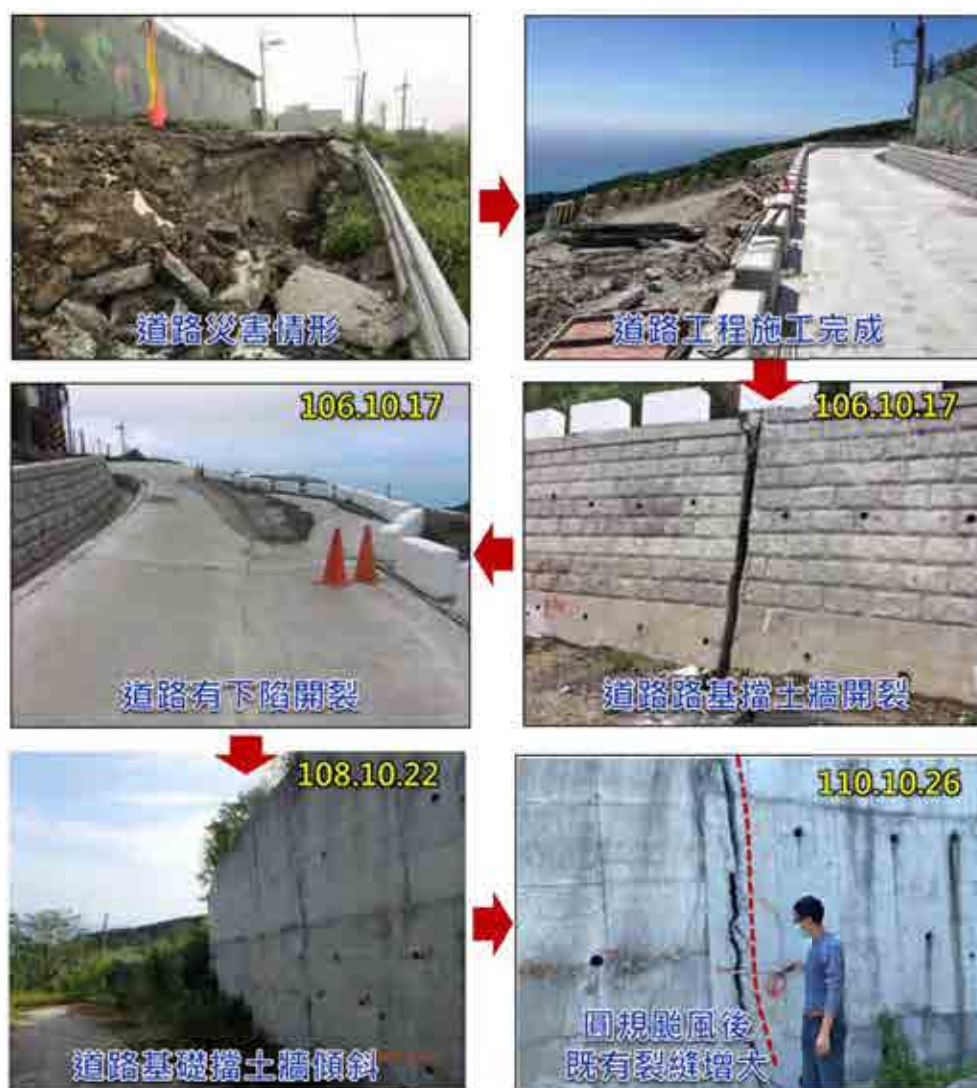
圖 3-17、賀田山調查區道路工程完工後仍有不穩定表徵發生
