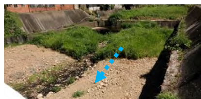
工區內河道大量淤積 (拍攝於2024.07.23)
