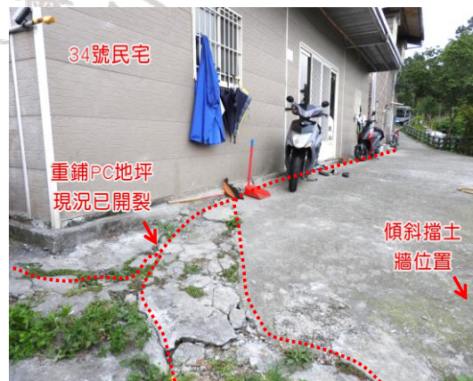
照片 B、教會附近民宅地坪再開裂
