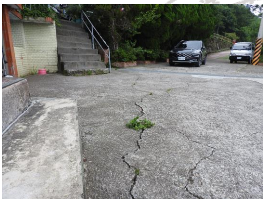
照片 A、教堂前路面開裂
